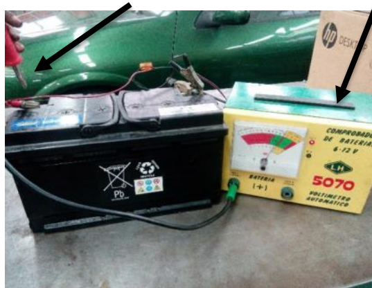
Borne descarga no conectado Probador baterías
