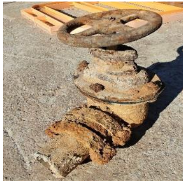
Tubería de fibrocemento muy envejecida.
